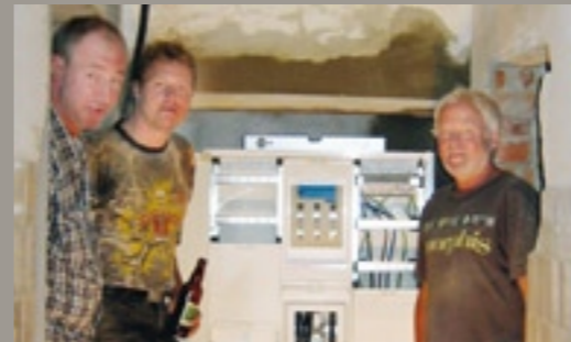
Ein Schaltschrank für das CT wird installiert, ohne dass ein CT in Aussicht ist! (2004)
